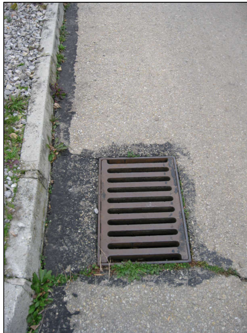
Fot. 6: jeden z istniejących wpustów deszczowych przewidzianych do wymiany na dostosowane do zwiększonego obciążenia.
