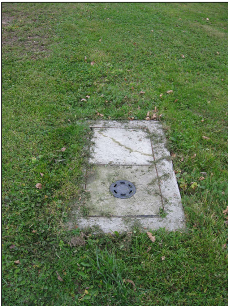
Fot. 5: Istniejąca studzienka teletechniczna na działce nr 765/4.
